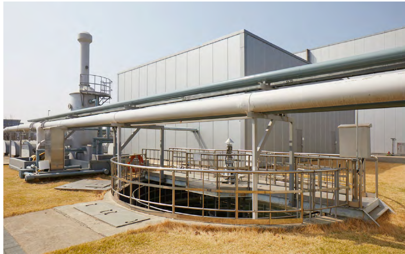
오산 뷰티파크 우수처리시설
