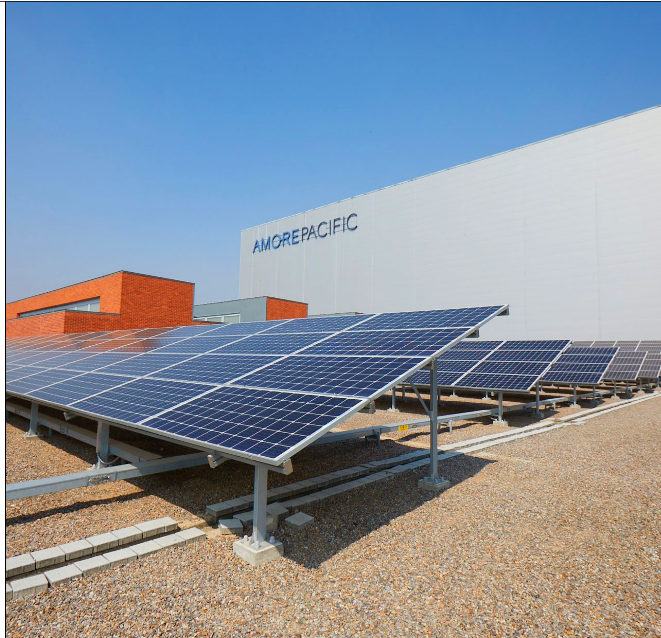
오산 아모레 뷰티파크 옥상에 설치된 태양광 설비
